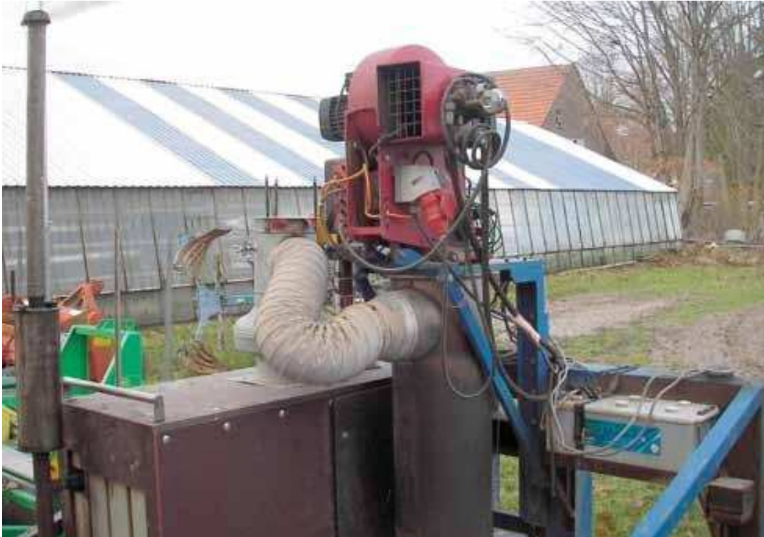
Abb. 3.2.5: Der Dieselmotor zur Stromerzeugung ist lärmgedämmt eingehaust; der Ölbrenner ist direkt auf dem Brennraum montiert
